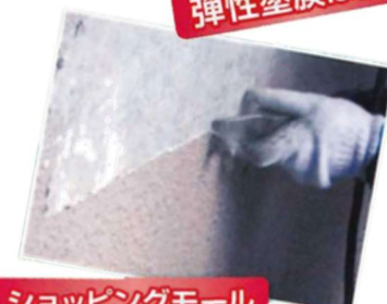
ショッピングモール 外壁塗膜剥離
